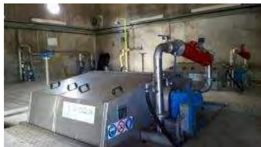
Atelier du traitement tertiaire
