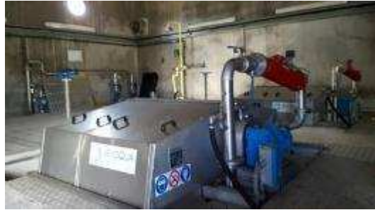
Atelier du traitement tertiaire
